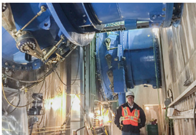
Turbina tipo bulbo instalada
